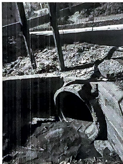
FOZ CANALIZADA DO PEQUENO CÓRREGO CUJO DEVIDO À DIMENSÃO DO TUBO SE TORNA UMA REPRESA AFUNILADA
