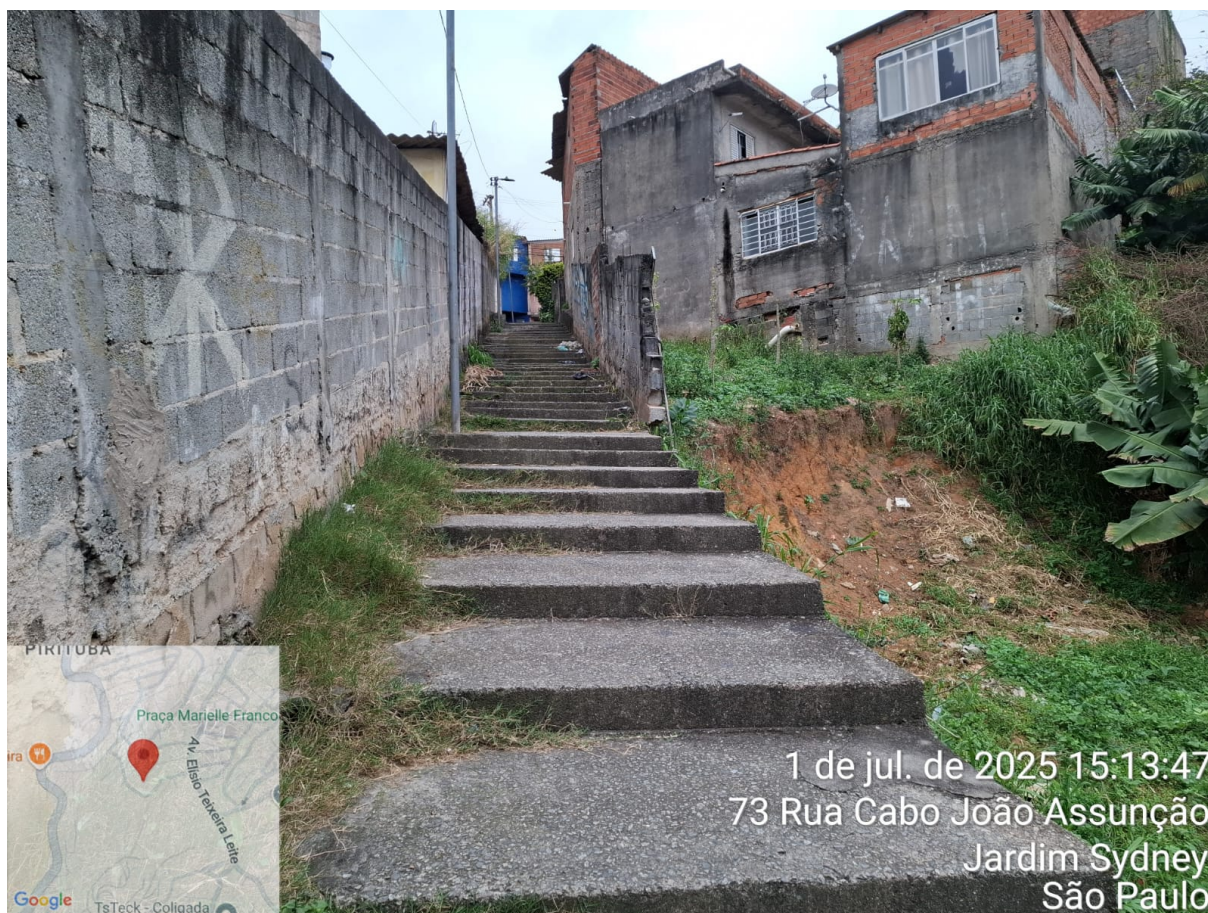
Necessidade de contenção do terreno
