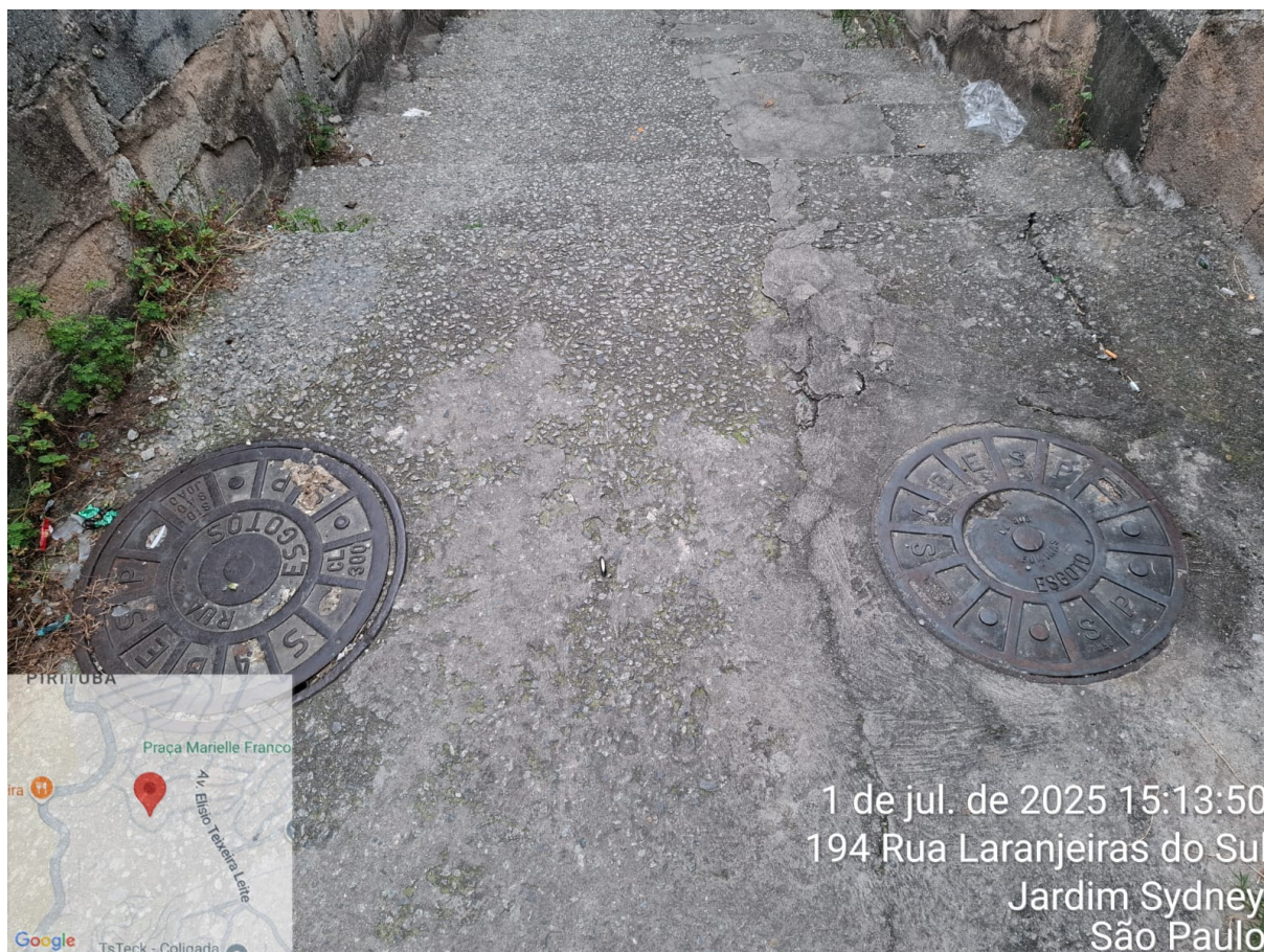
Poços de visita (PV) da rede de esgoto
