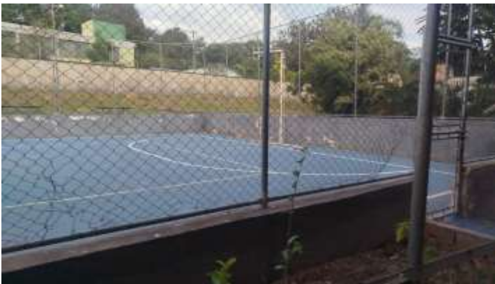
Imagem 2 – Área lateral e necessidade de melhorias estruturais.
